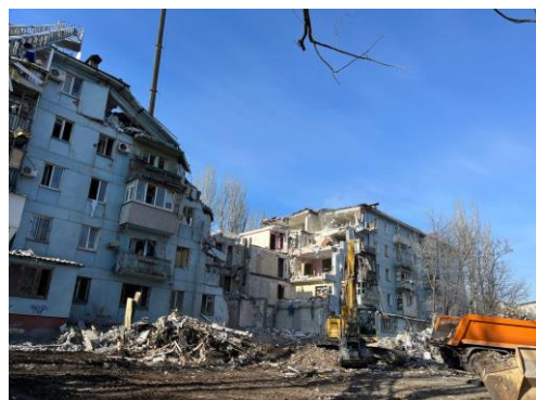
露軍のミサイル攻撃により破壊されたザポリヅジャ市の集合住宅（2023年3月） 【ウクライナ緊急事態庁】
