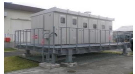
受変電設備の高所化 (津波対策)
