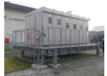
受変電設備の高所化（津波対策）
