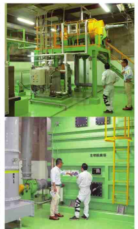
上：ドラムスクリーン(搬入されたし尿及び汚泥のゴミなどを取り除く)。 下：生物脱臭塔(高・中濃度臭気を生物により脱臭し、大気へ放出できる基準に押さえる。)
