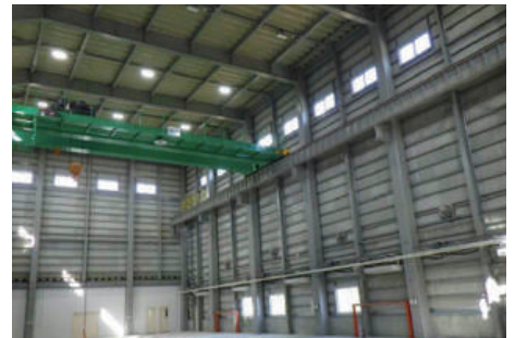
整備場の内部に設置された天井クレーン
