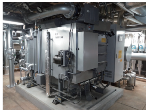
陸上自衛隊青森駐屯地 冷凍機
