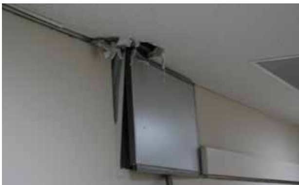
天井のボードが壊れた箇所（地下1階）
