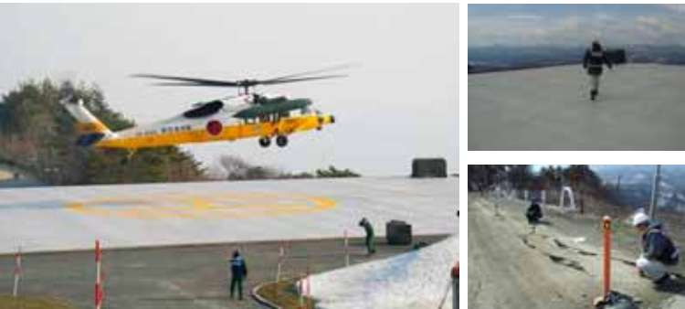
△ 山田分屯基地 ヘリポート及び進入路被害調査
