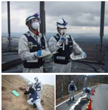
△ 大滝根山分屯基地 進入路等被害調査
