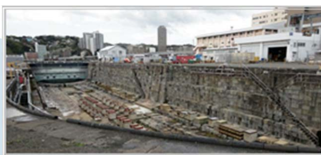
艦船の修理の際に使用されるドライドック
