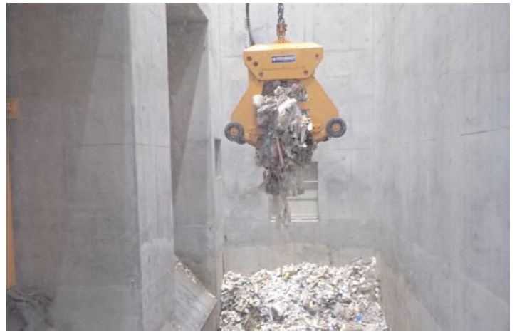
ごみピット・ごみクレーン
