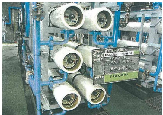
簡易水道施設機器補修事業 (渡名喜村)
