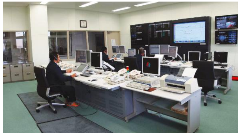
高機能消防指令センター
