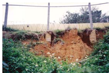
【大雨による崩落現場】
