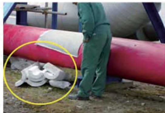
二つ割りのケイカル系石綿保温材。非常に軽く断熱性に優れていますが、もろくて発散しやすいのが欠点。放置すれば自然劣化により飛散し、敷地を往来する労働者がばく露する可能性があります。
