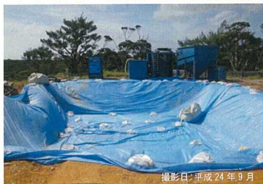
(沈殿池と濁水処理プラント)
