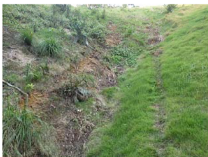
削れた斜面の状況
