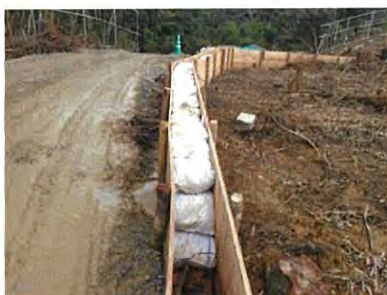
赤土流出防止柵
