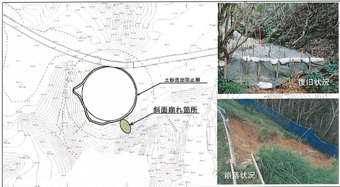
図 4.5-1 崩落地点及び崩落状況
