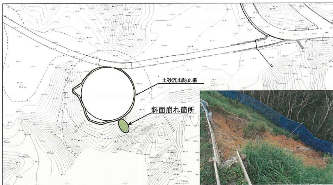
図 4.5-1 崩落地点及び崩落状況
