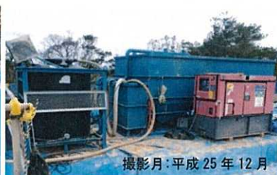
(濁水処理プラント)
