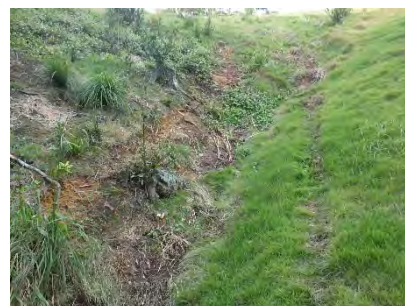
削れた斜面の状況
