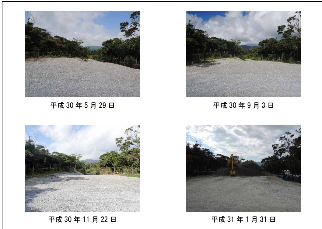
図 6.1.3-80 工事による副次的影響の復元箇所の状況(既存道路北側作業ヤード)
