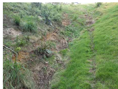
削れた斜面の状況
