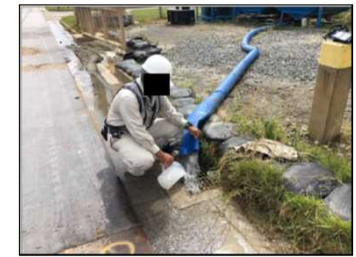
濁水処理プラントでの処理水の採水状況 (10月17日)
