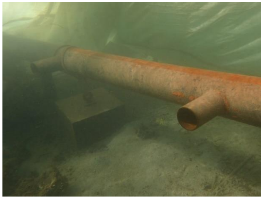
配管（吐出口）の状況
