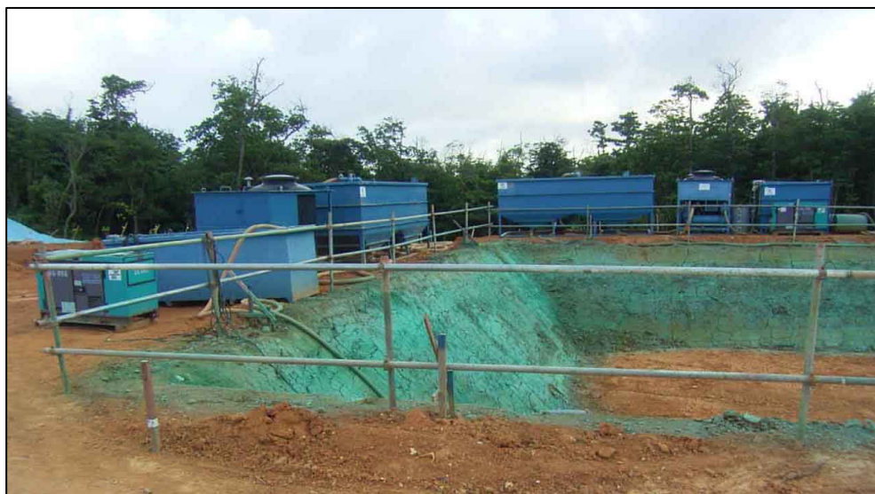
図-6.7.3.1.3 調整池及び濁水処理プラントの設置事例(米軍泡瀬ゴルフ場移設事業)
