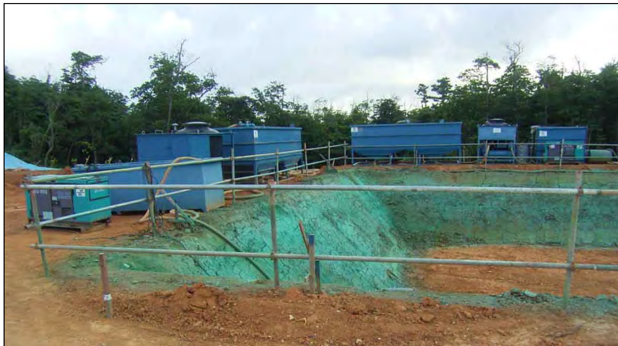
図-6.7.2.1.5 調整池及び濁水処理プラントの設置事例(沖縄防衛局)
