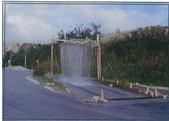
図-6.7.3.2.3 碎石場洗浄設備（参考）
