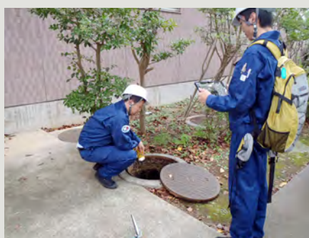
汚水管の損傷状況確認
