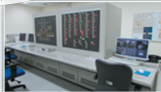
特別高圧受配電施設 (26年度完成)
