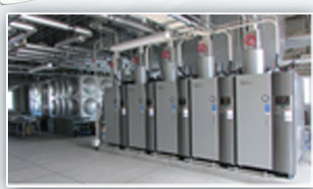
ボイラー室 (24年度完成)
