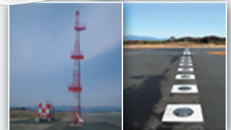
航空灯火設備 (24年度完成)
