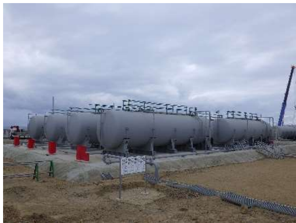
仮設燃料タンク
