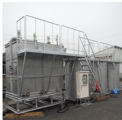
濁水処理プラント（イメージ）
