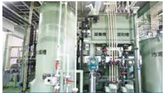
凝集沈殿処理設備
