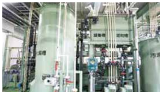
凝集沈殿処理設備
