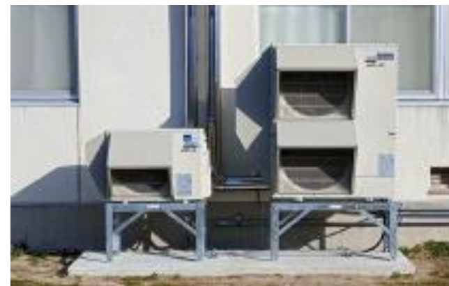
パッケージ型空気調和機(室外機)
