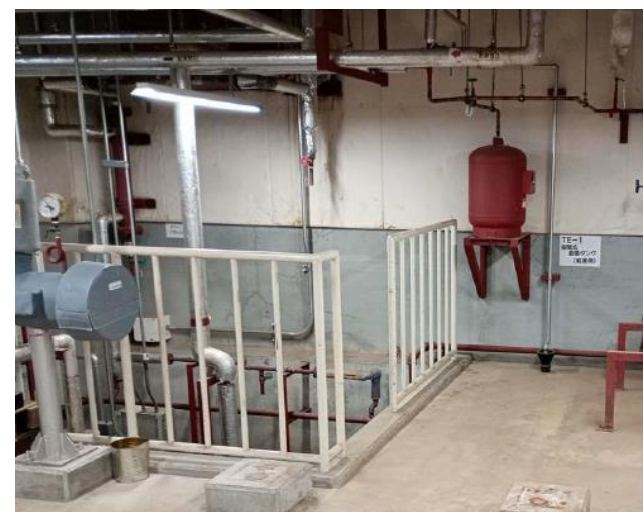
中央方式撤去後の機械室
