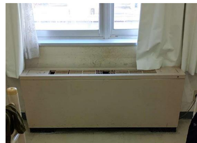
既存のファンコイルユニット
