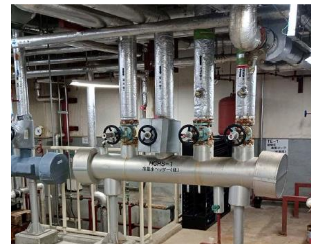
既存の中央方式の機械室
