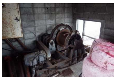
【整備前】巻揚施設（ウインチ）※
