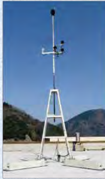
島根県江津市桜江総合センターに設置した騒音測定器
