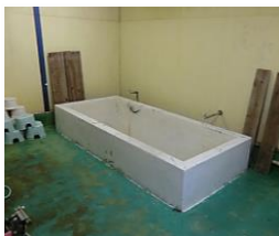
劣化した浴室
