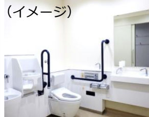
多機能トイレの設置
