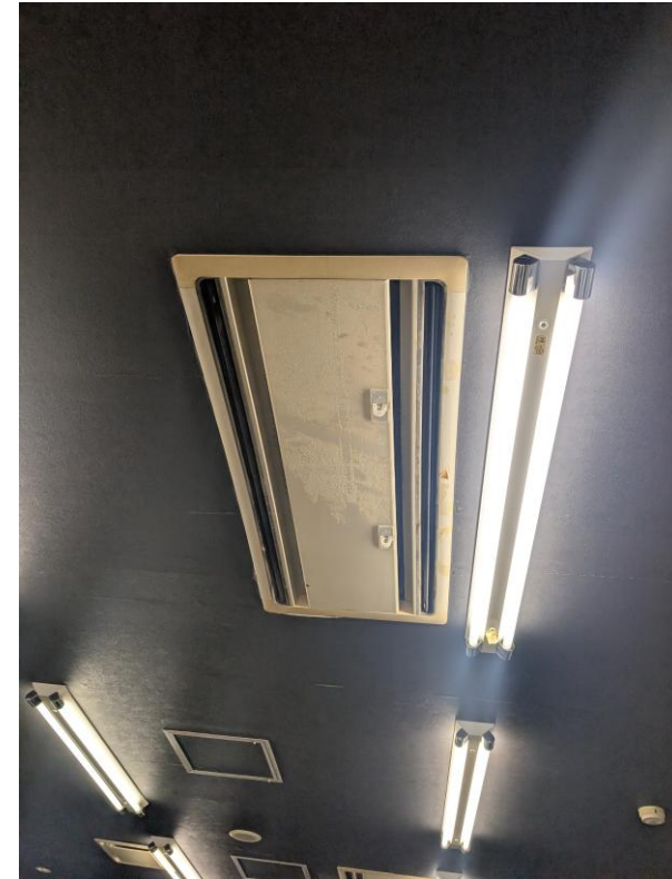
(空調機室内機)
