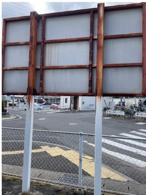
【看板裏面の状況】
