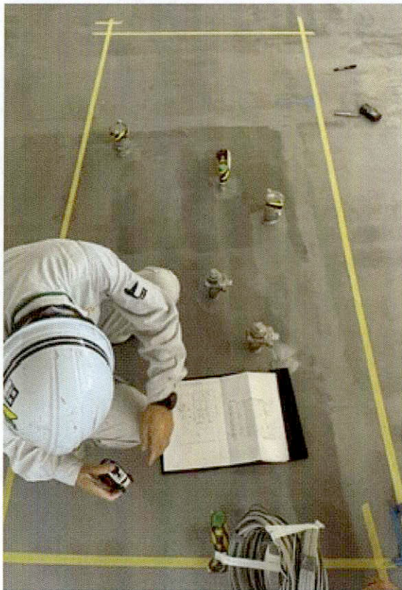
ガスレンジ、焼物機設置場所
