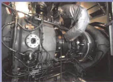
艦のエンジンの様子 航空機のジェットエンジンを 船でできるように改良し 使用しています。
