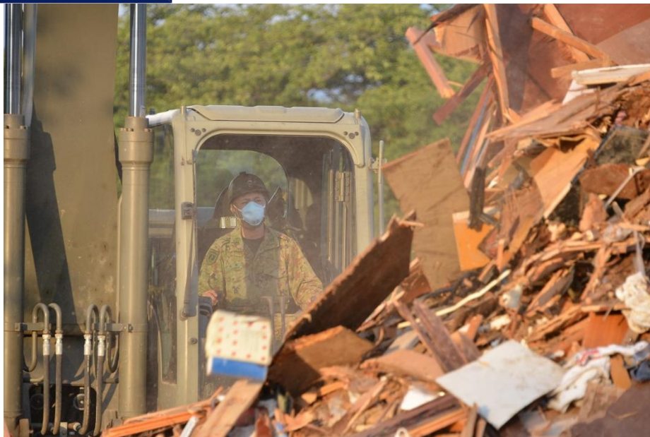
災害廃棄物の撤去（秋田市）
