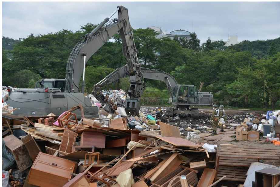
災害廃棄物の撤去（秋田市）
