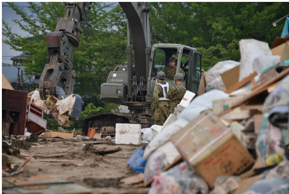
災害廃棄物の撤去（秋田市）
