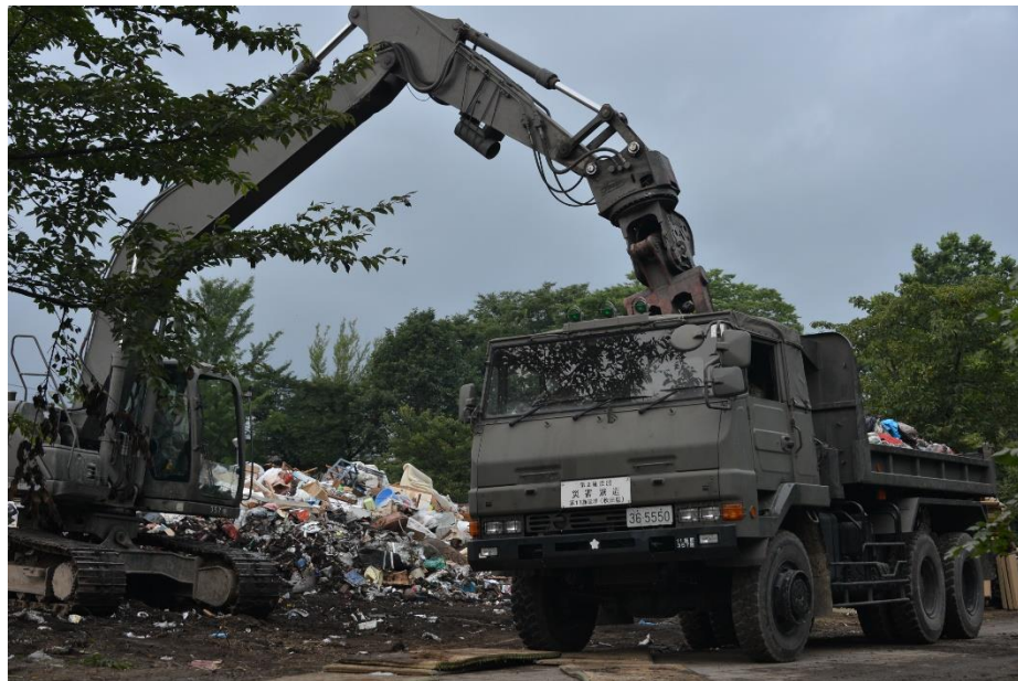
災害廃棄物の撤去（秋田市）
