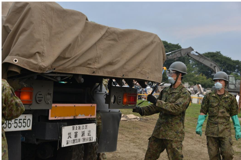
災害廃棄物の撤去（秋田市）
