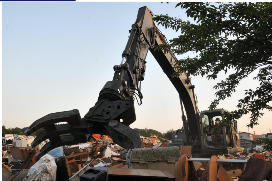
災害廃棄物の撤去（秋田市）
