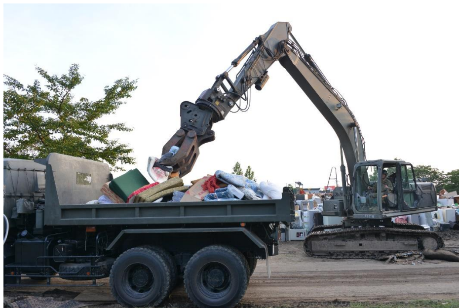
災害廃棄物の撤去（秋田市）
