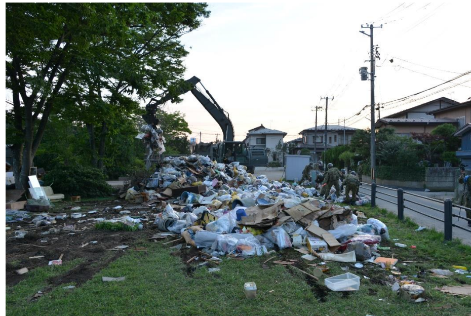
災害廃棄物の撤去（秋田市）
