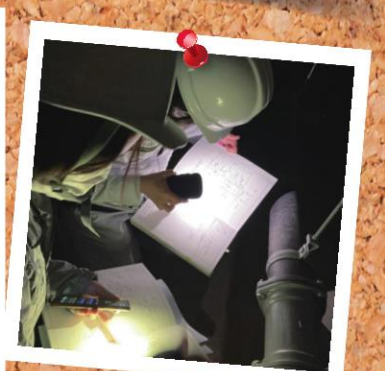
建物下のビット内。暗闇に埃にまみれて、配管の仕上がりをチェックする。機械設備担当監督官の宿命です。
