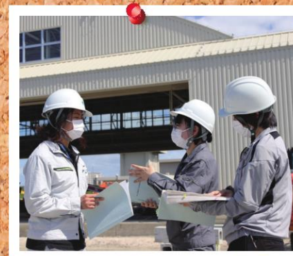
自衛隊基地での建設現場です。工事図面をしっかりと理解し、現物をしっかりと見る。「学び」「気づき」「疑問」の連続で、3人で話し合うこともありました。
