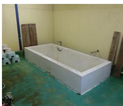
劣化した浴室
