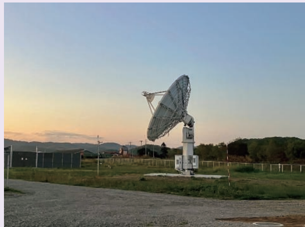
衛星との通信に用いられるアンテナ
