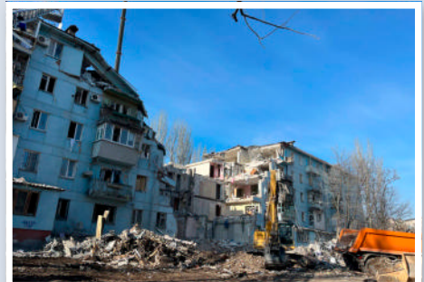
露軍のミサイル攻撃により破壊されたザポリヅジャ市の集合住宅 (2023年3月5日ウクライナ非常事態庁公表画像)
