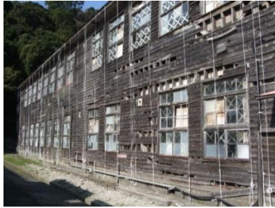
↑ 老朽化が進んだ倉庫
