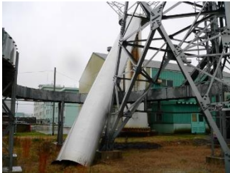
↑ 老朽化が進み、倒壊したボイラー煙突。
