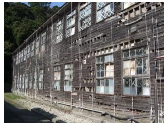
↑ 老朽化が進んだ倉庫
